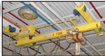
MT.CLEMENS 2 ton crane
