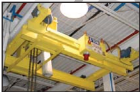
MT.CLEMENS 5 ton crane
